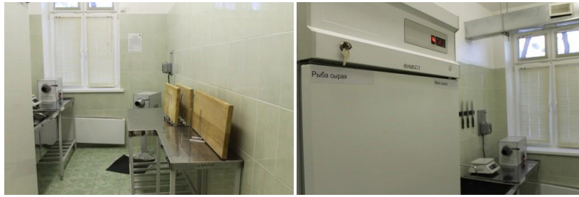
Рис. 7. Оборудование мясорыбного цеха
