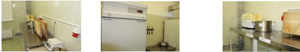
Рис. 14. Оборудование холодного цеха
